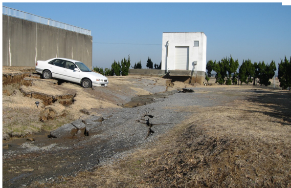
写真6 河内町水道管理事務所における地盤変状と管理事務所の基礎の抜け上がり（河内町提供）
