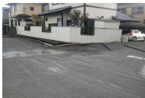
写真7 利根町羽根野台における地盤変状と家屋被害（利根町提供）
