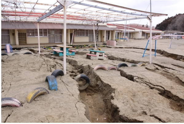
写真1 銚田市立第二保育所の園庭における地割れ (位置は図6参照、茨城県提供)
