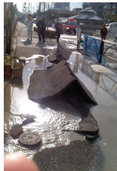
写真8 葛飾区東金町7丁目における地盤変状。写真右手は緩やかな上り坂（住民提供）
