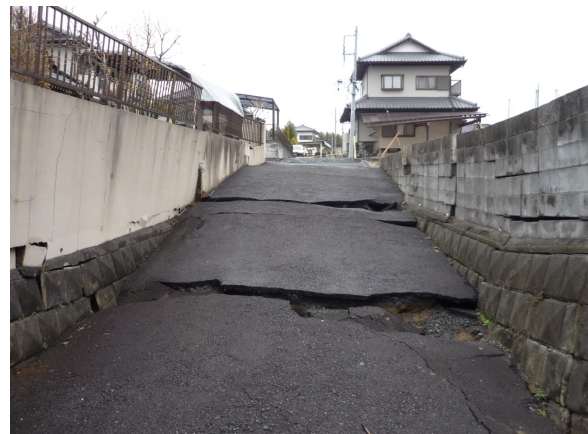
写真3 石岡市鹿の子4丁目における沢埋め盛土の造成地の被害（茨城県提供）
